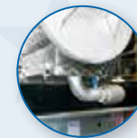
ABTROPFFLÄCHE MIT ABSPERRSCHIEBER
