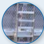
INSPEKTIONSTREPPE AUS VERZINKTEM EISEN
